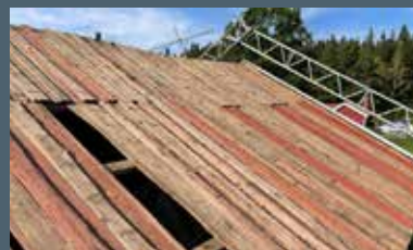
Bilden visar hur dåligt taket var innan reparationen. Nu kunde vi ta bort de många extra plåtarna som vi satt upp under taket inomhus för att leda bort den inträngande vattnet.
