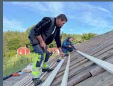
Patrik och Alex i arbete med att spika bärläkten. Observera att det inte har lagts någon papp på detta tak.
