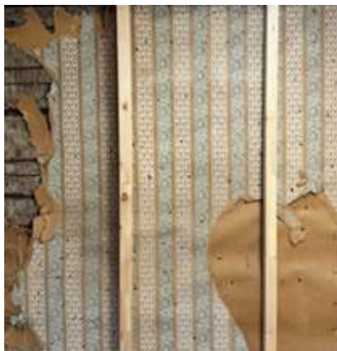
Utanpå spännpappen sitter denna tapet som är tryckt med limfärg på brunt papper. Reglarna har spikats utanpå så att dessa lager bevaras för framtiden.
